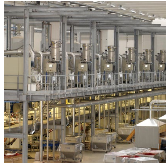
Ciąg linii technologicznych do produkcji farb proszkowych.
